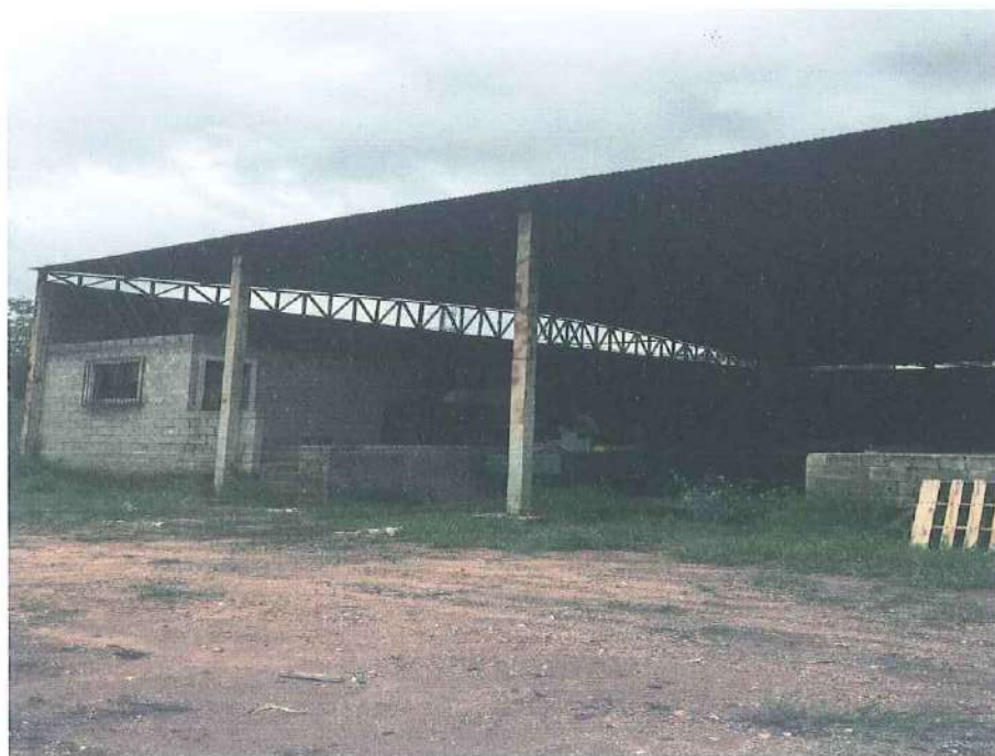
Demonstração geral do estado regular de conservação do galpão e da área de manobra de veículos sem pavimentação.
