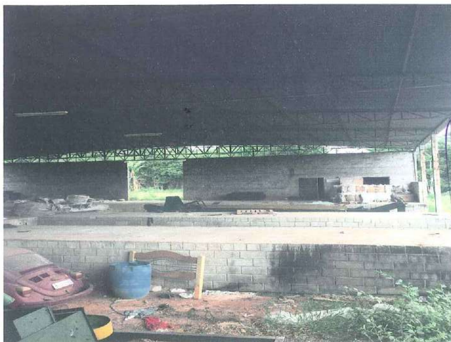
Destaque geral do galpão e sua cobertura em estado regular de conservação.
