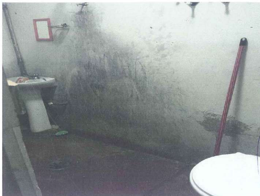
Destaque do banheiro e suas instalações.
